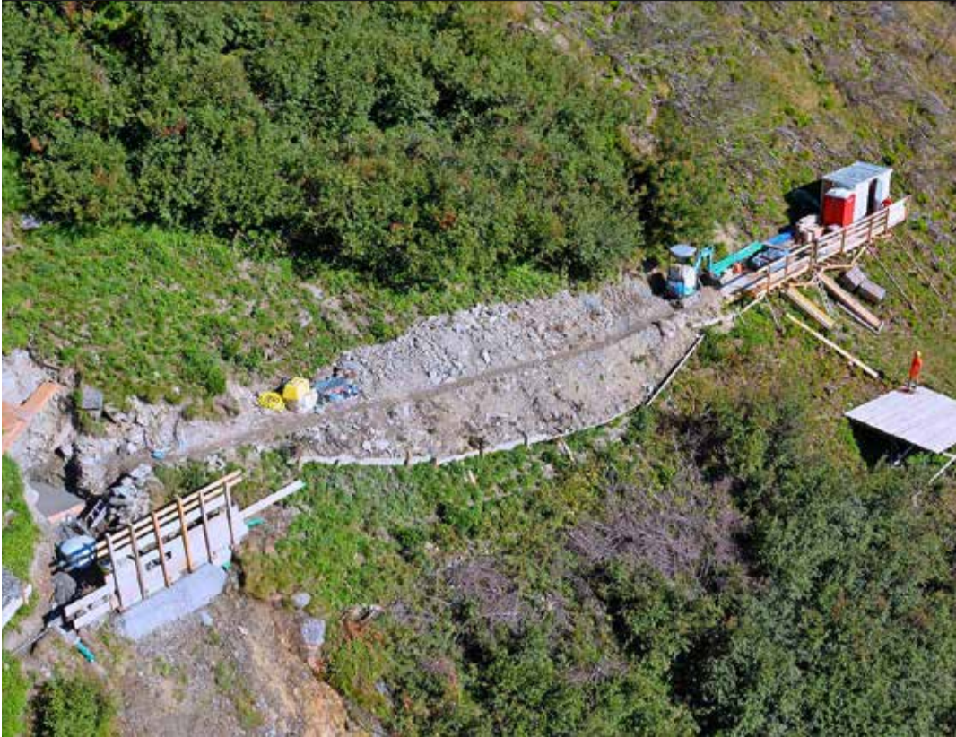
Ausgesetzt: Die Baustelle mit der Quellfassung (links) im Weertobel klebt wie ein Adlerhorst am Steilhang.
