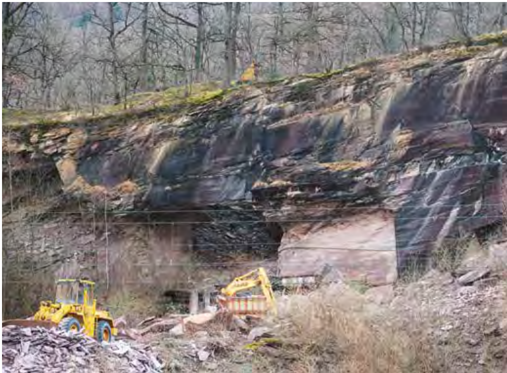
Aus dem Steinbruch Tiergarten herausgebrochen (links), in Form gesägt (ganz links) und schliesslich auf den Rathausplatz angeliefert: Die Verrucanplatten, mit denen der Platz eingefasst wird.
